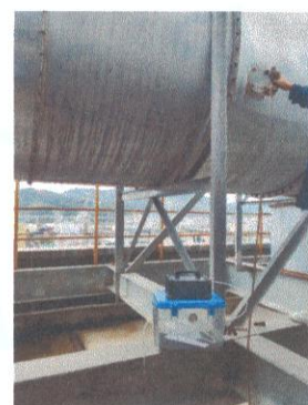
研发室排气筒出口 03#
