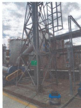
罐区一排气筒出口 04#
